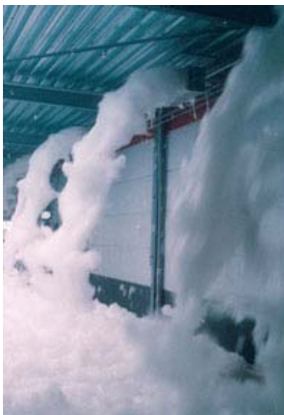
Figuur 13: lichtschuimsysteem in werking (inside-air)
