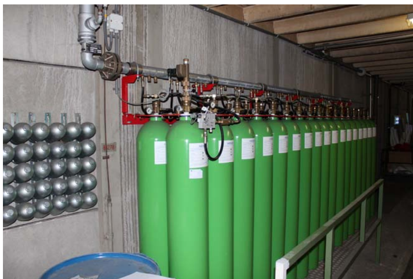
Figuur 4: Inert blussysteem opstelling t.b.v. PGS-15 opslag
